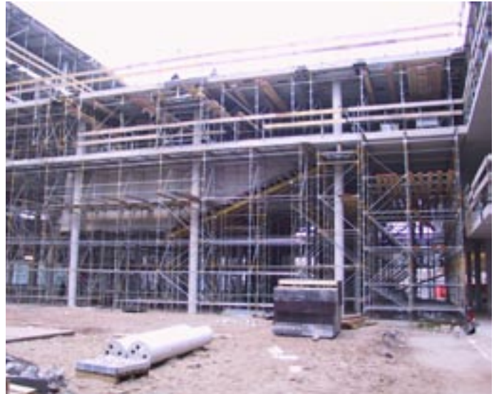
Matemco levert de ondersteuningsconstructie voor het 55.000 m 2 tellende vloeroppervlak van het nieuwe FNWI.
